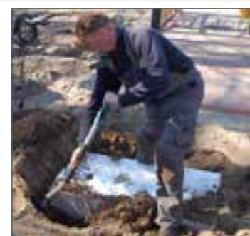
Naast de 2 ingegraven D112 blokken graaft u de infiltratieput IP15 in. De infiltratieput steekt minimaal 10 cm plus de dikte van de bestrating boven de infiltratieblokken uit.
